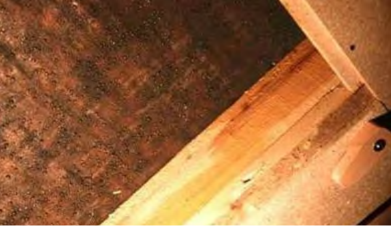
Condensatie recht tegenover het dakbeschoot
