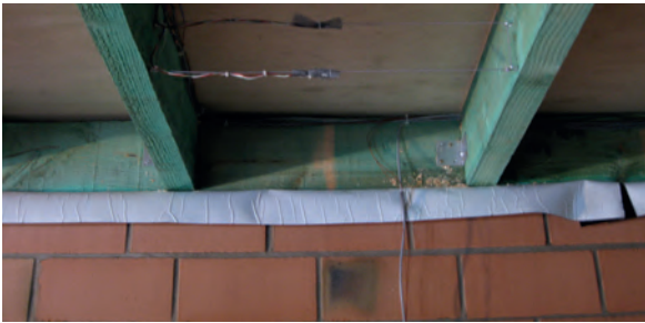
Plaatsing van een membraan in het geval van balken die op het metselwerk steunen (illustratie magazine WTCB-Contact n° 33, 2012)
